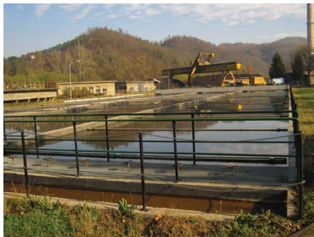
Slika 1. Bazen za prečišćavanje otpadnih voda.
