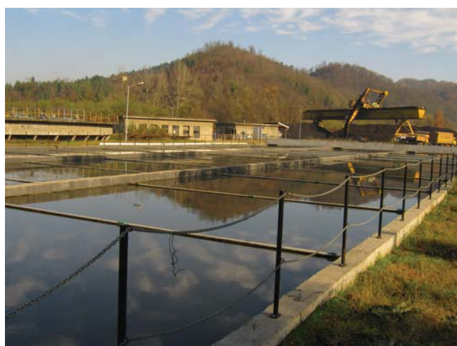
Slika 3. Bazen za prečišćavanje otpadnih voda.
