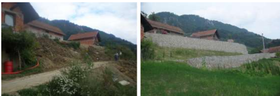
Slika 10: a) prije sanacije; b) sanirano/poslije sanacije
