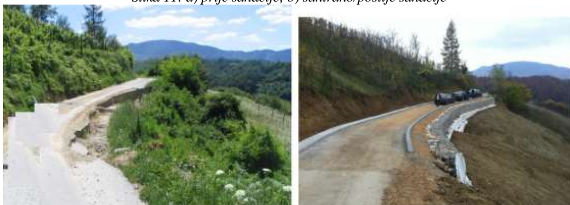
Slika 12: a) prije sanacije; b) sanirano/poslije sanacije
