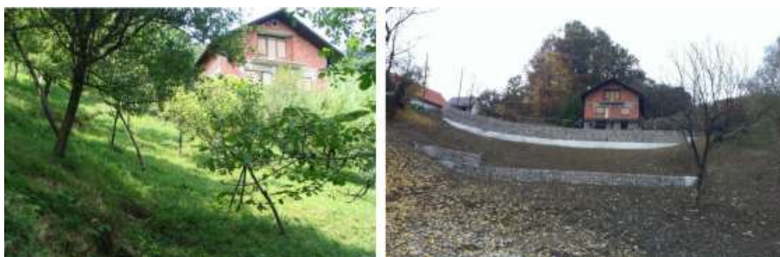
Slika 11: a) prije sanacije; b) sanirano/poslije sanacije
